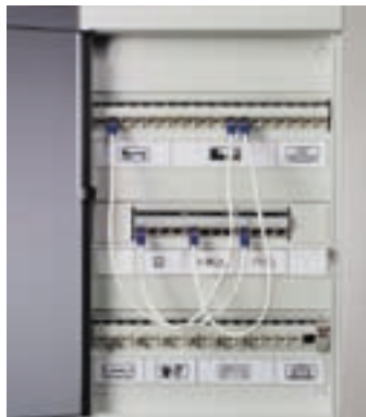
Ansicht Verteiler mit geschlossener Abdeckung: Klare Abgrenzung für den Benutzer.
